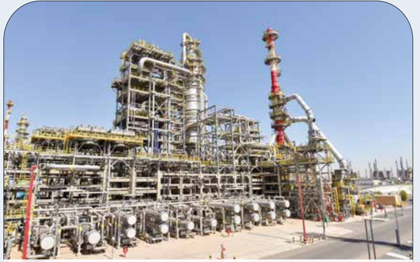
● وحدة التقطير الفراغي (U-213) بمصفاة ميناء عبدالله
