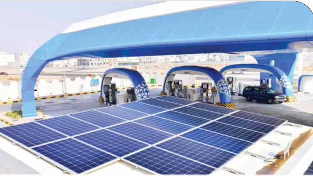
● تزويد محطات تعبئة الوقود الجديدة بألواح شمسية لتوليد الكهرباء
