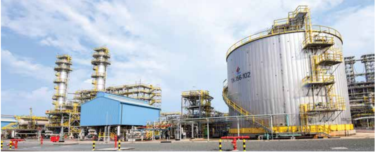
■ مشروع الوقود البيئي يستخدم تكنولوجيا متطورة تسهم في تحسين كفاءة استخدام الطاقة
