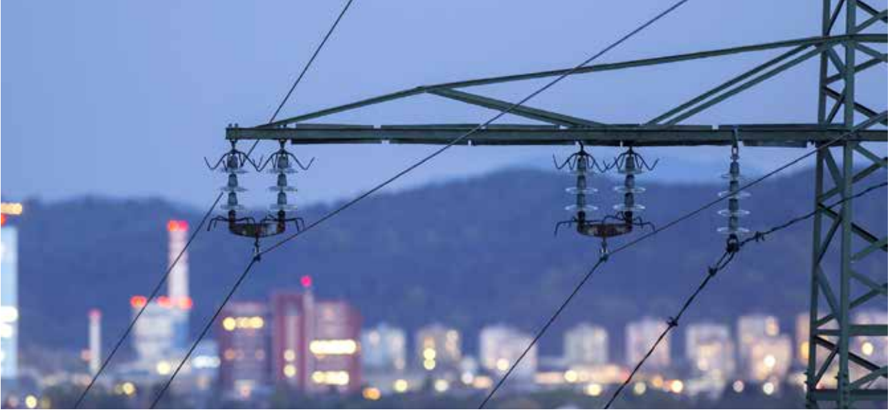
■ الأبراج تستخدم لنقل الكهرباء لمسافات طويلة
