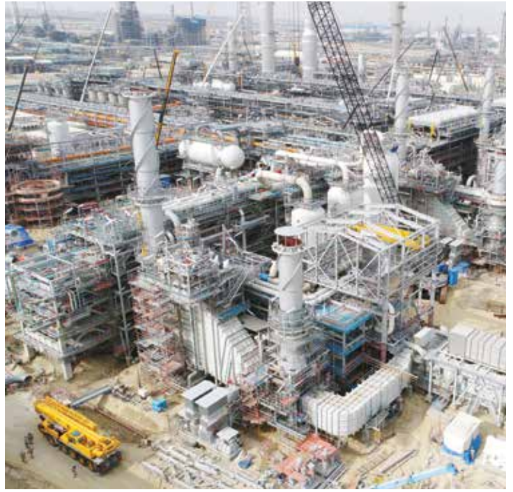
■ خط الغاز الخامس - مصفاة ميناء الأحمدى
